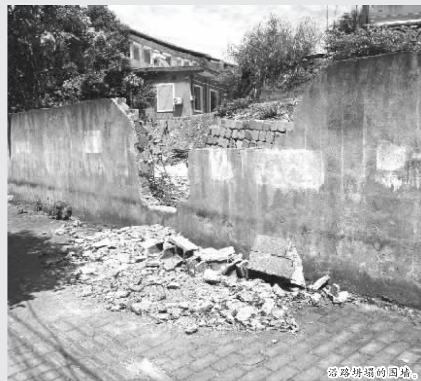
沿路坍塌的围墙。
