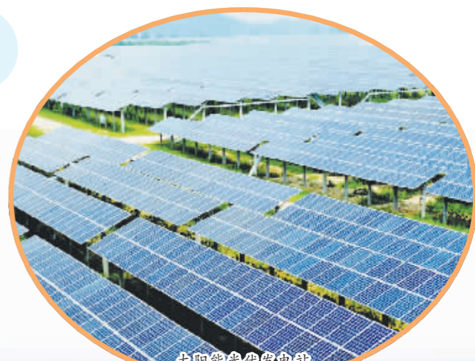
太阳能光伏发电站
